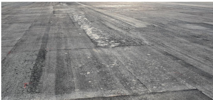
Visão de parte central da PPD com vários remendos e patologias aparentes.
