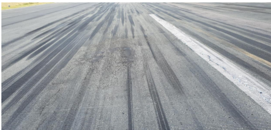
Visão da parte central da PPD com patologia tipo couro de jacaré.
