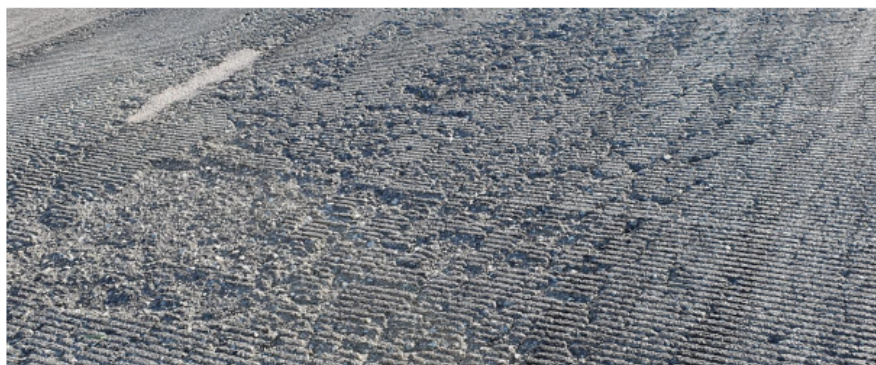
Área de grooving em estado precário na PPD.
